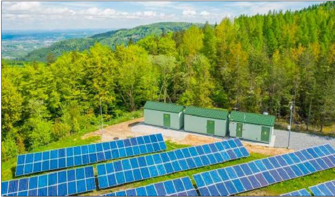
Zdjęcie 3 Magazyn energii na górze Żar o mocy 500 kW i pojemności użytkowej 750 kWh
