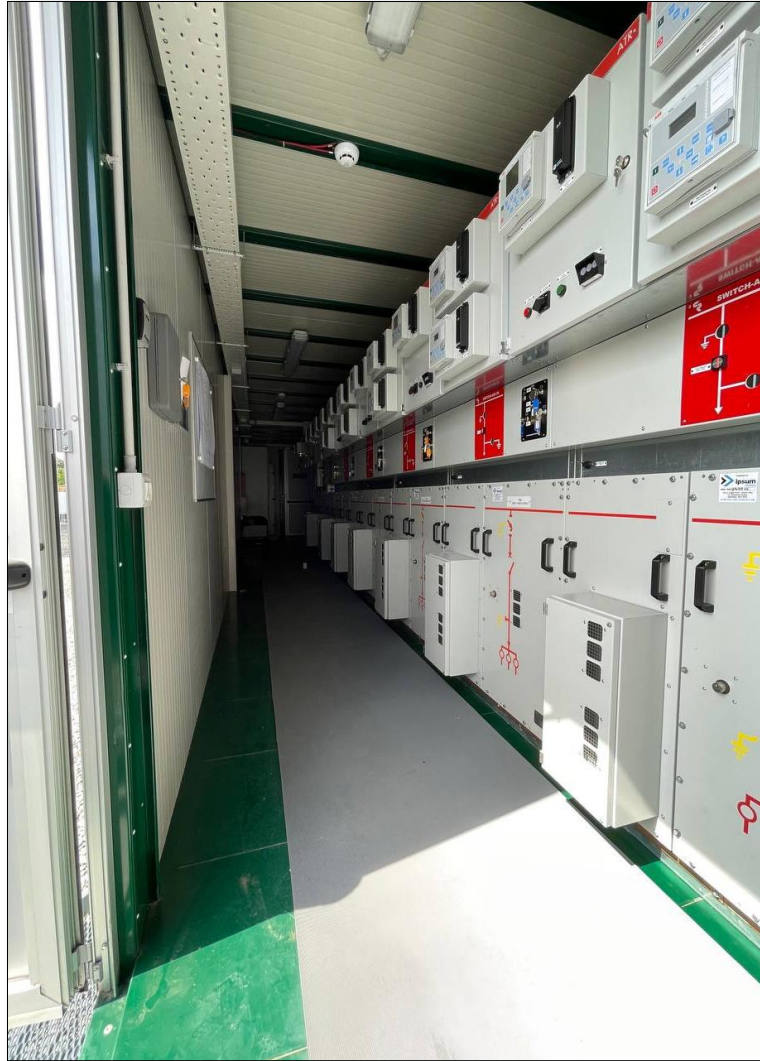
Rysunek 6 Wnętrze kontenera/budynku technicznego
