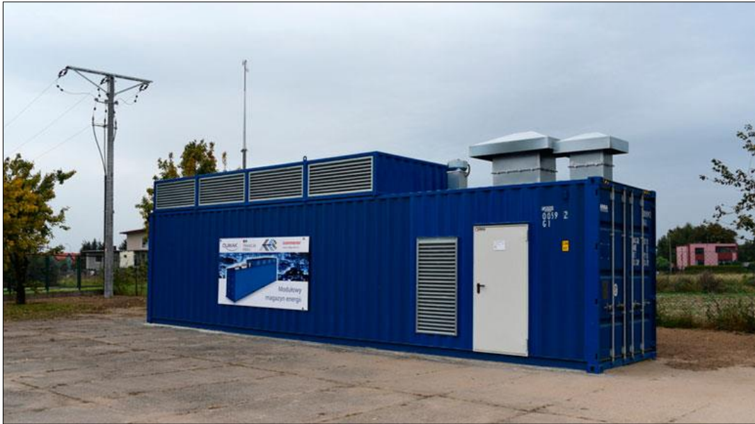
Zdjęcie 1 Przykład magazynu energii typu kontenerowego
